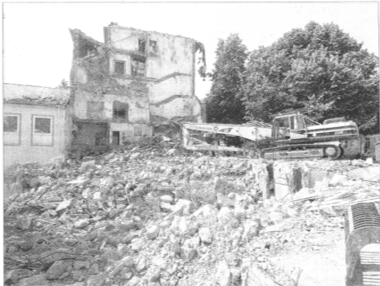
Bagger statt Behandlungen: Der ehemalige Anbau der Rheumaklinik an der Benediktinerstraße ist bereits weitgehend abgerissen. Rund 16 Millionen Euro werden in den Neubau investiert. Foto: Wolfgang Piltzner
