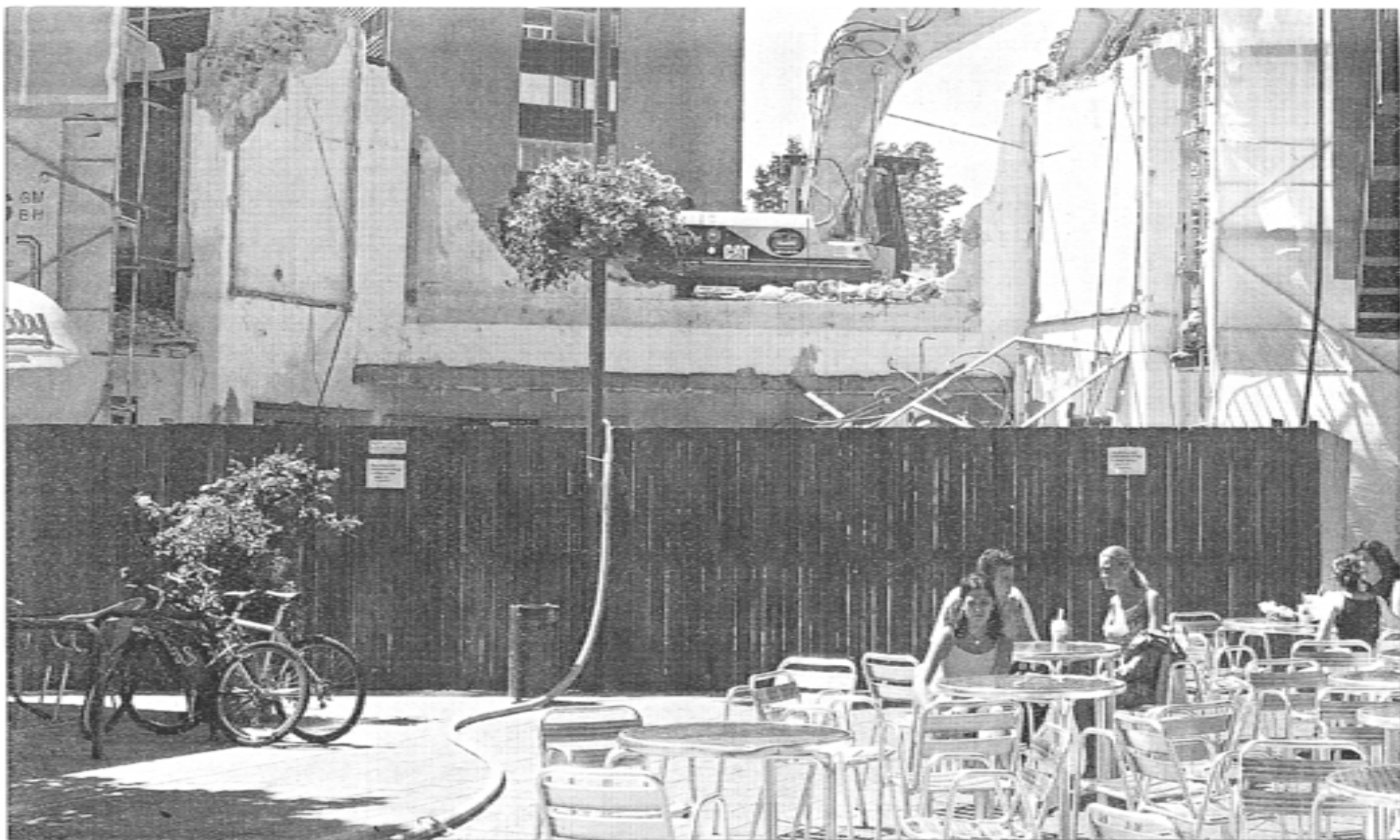
Außergastronomie am Holzgraben in diesen Tagen. Ein Bild, das den Umbruch der Innenstadt deutlich symbolisiert: Das Traditions kino Bavaria ist abgerissen, im Hintergrund arbeitet ein Bagger auf der Großbaustelle Mayersche.
